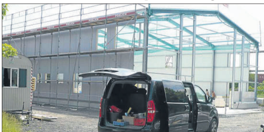
Ende des Jahres bezugsfertig: das neue Büro-, Lager- und Werkstattgebäude des Haustechnik-Spezialisten HKW aus Körle, der seinen Sitz nach Kassel verlegt. Foto: Pinto
